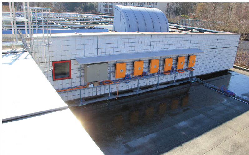
Vue des onduleurs.
