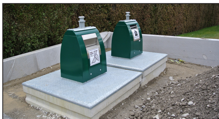
Deux conteneurs enterrés situés à l'avenue Louis Yung/Stade municipal.
