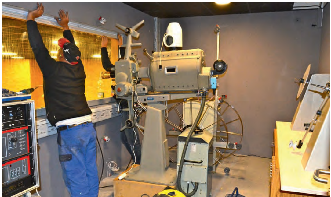
La nouvelle cabine en chantier. Elle permet à CinéVersoix des projections en 35mm et, en numérique
